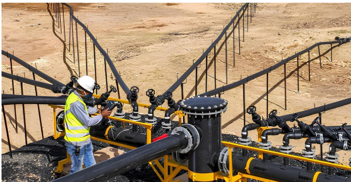
Figura 47: Poço de Captação de Biogás
