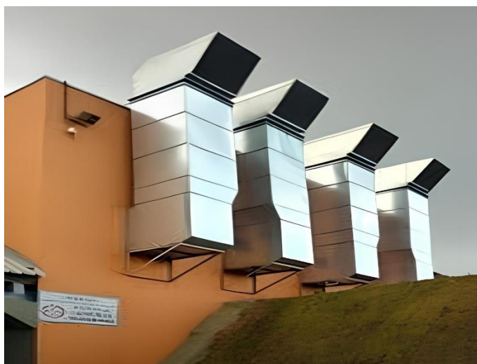
Figura 25: Sistema de Exaustão de uma ETR
